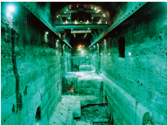
工事名：小丸川発電所新設工事のうち土木本工事（第3工区） 小丸川発電所新設工事のうち発電所本館新築工事（宮崎県） 発注者：九州電力株式会社
