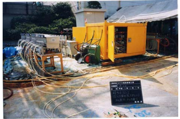
写真－2 注入設備全景
